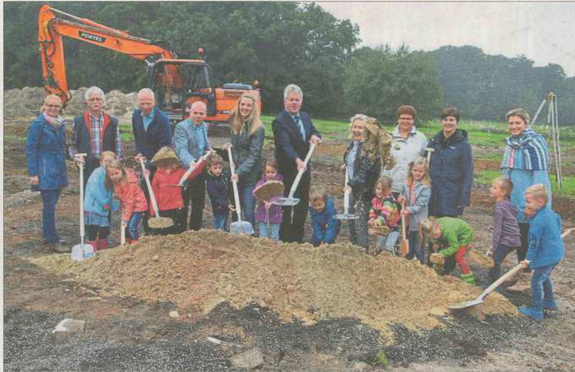
Mit vereinten Kräften haben die großen und kleinen Gäste den 2,5 Millionen Euro teuren Neubau der Kindertagesstätte St. Franziskus in Emsbüren gestartet. Den Großteil der Kosten muss die Gemeinde tragen. Foto: Heinz Krüssel
